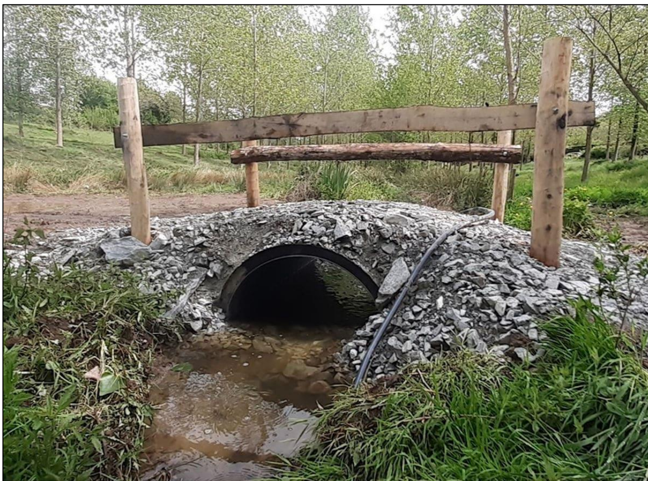
Figure 16. Exemple de busage avec fond naturel – photo d'un passage créé lors de la mise en défens d'un cours d'eau en Vendée.
